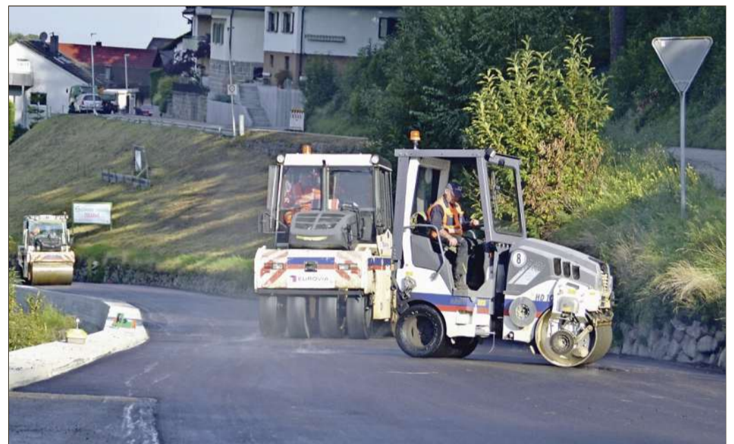
Drei Walzen sorgen nach dem Asphaltbau für eine topfebene Piste auf der Sandstraße am östlichen Ortsausgang von Bühlertal.
