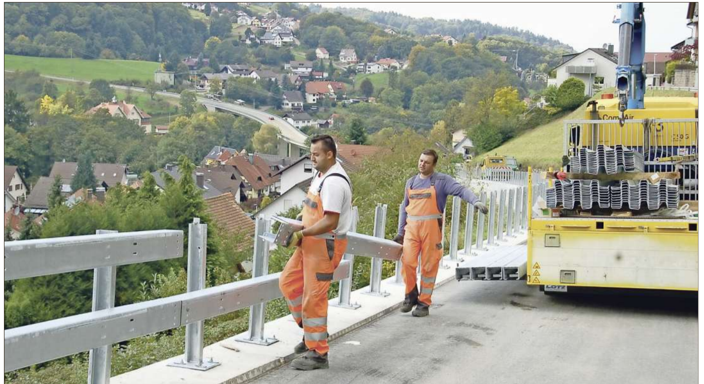
Auf der neuen Stützmauer befestigen Monteure Doppelleitplanken zum Schutz der darunter liegenden Wohnbebauung.
