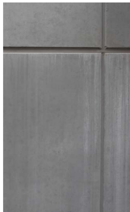
Betonplatten ENBW Umspannwerk (benachbart)
